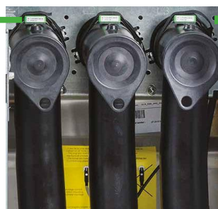
TH110 lắp đặt tại đầu nối cáp
